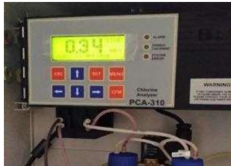
Sistemas de tratamiento de agua (Cloración)
